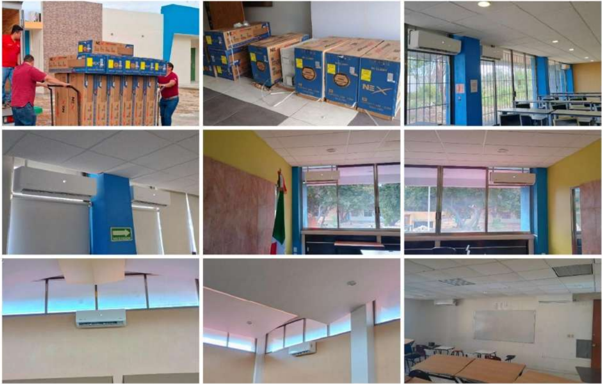
Fotografías 9. Instalación de Aires Acondicionado con recurso del Programa de Expansión U079 2025
